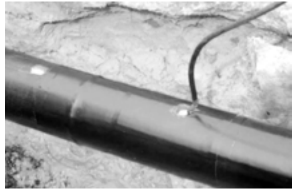
Рисунок 1 - Несанкціоноване порушення герметичності лінійної частини нафтопродуктопроводу ТОВ «Прикарпатзахідтранс»
